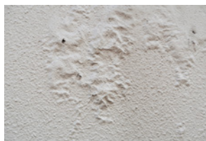
塗装の浮き、剥がれ
