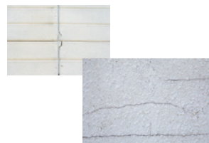
外壁のひび割れ
